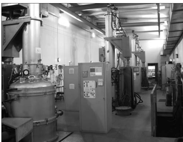
Рис. 13. Зал установок выращивания УВК-300 Fig. 13. Appearance of UVK-300 growth plant
